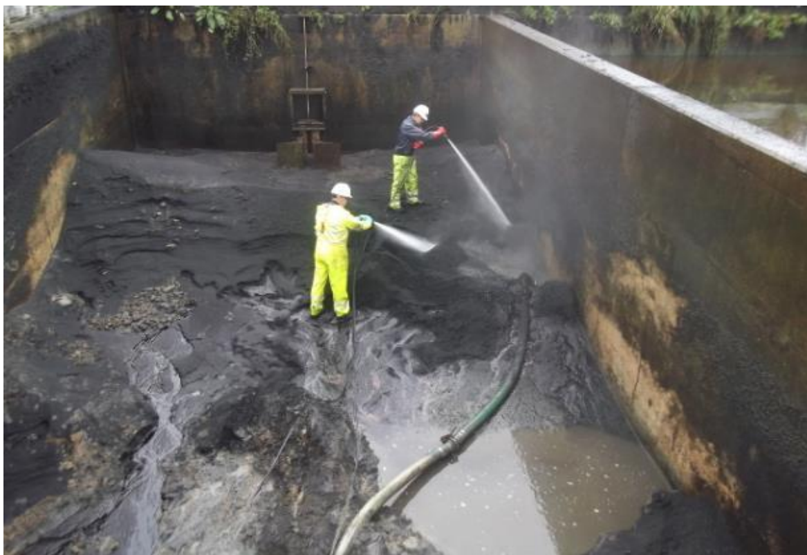
Zamulone dno zbiornika retencyjnego
